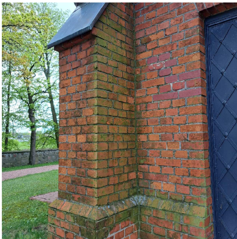
Fot. 5 Widok na elewację północną – porażenie murów elewacji przez mikroflorę/florę
