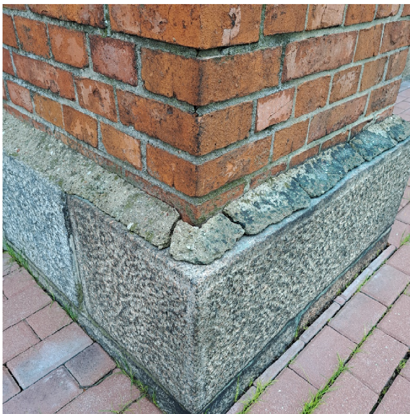
Fot. 6 Widok na elewację północną – uszkodzenia „faset” cokołu
