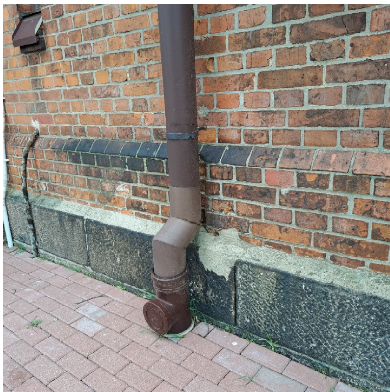
Fot. 10 Widok na elewację północną – uszkodzenia cokołu
