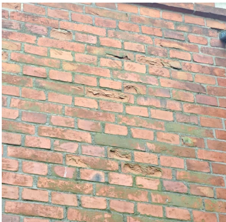
Fot. 7 Widok na elewację południową i północną – próba naprawy ubytków cegły , uszkodzenia murów elewacji
