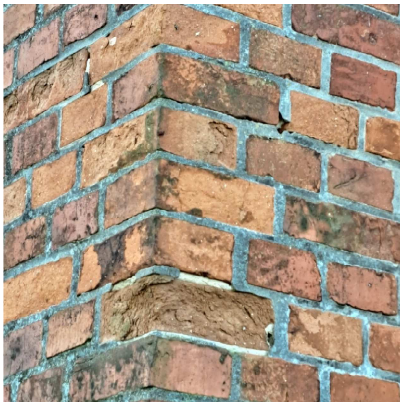
Fot. 11 Widok na elewację południową – uszkodzenia elewacji muru
