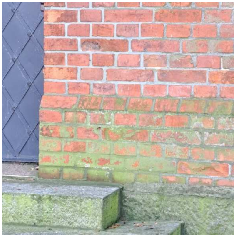
Fot. 8,9 Widok na elewację północną – uszkodzenia elewacji ceglanej oraz cokołu, porażenie murów przez florę/mikroflorę
