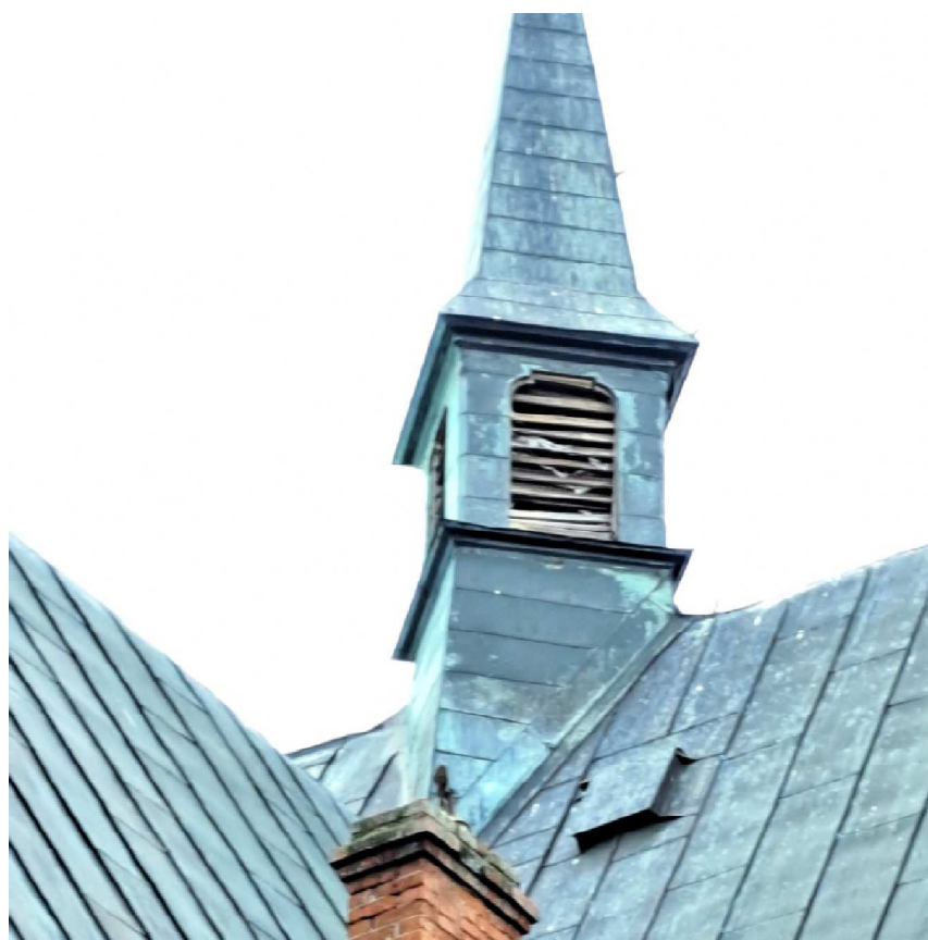
Fot. 12 Widok na sygnaturkę – uszkodzenia drewnianych żaluzji
